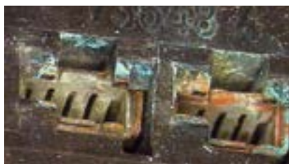
Kupplung mit Feuchtigkeit und Korrosionsspuren
