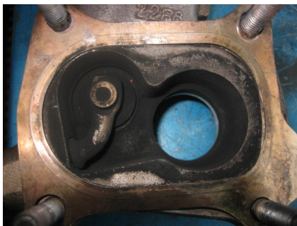
Guarnizione montata non correttamente
